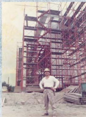
1986年頃 サントリー白州蒸留所構内 屋根工事確認時(二代目 勉三)
