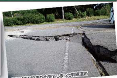
亀裂が走り段差が出来てしまった幹線道路
